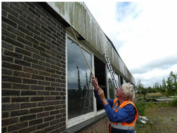
Onderzoek naar kieren, gaten en uitwerpselen.
