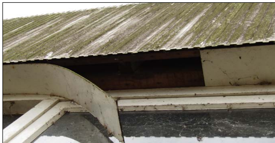
Figuur: de dakrand is op meerdere plaatsen open, waardoor tocht ontstaat. Dit maakt de dakrand voor vleermuizen ongeschikt.
