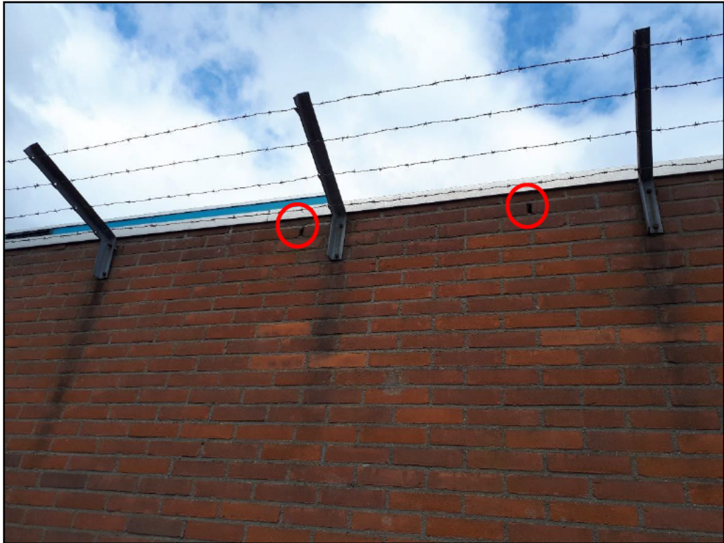
Voorbeeld van de aanwezige open stootvoegen in het gebouw.
