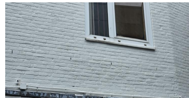
Figuur 12: Bebouwing aan de Van Manderslootstraat 54 t/m 58, met kierende dakranden en open stootvoegen
