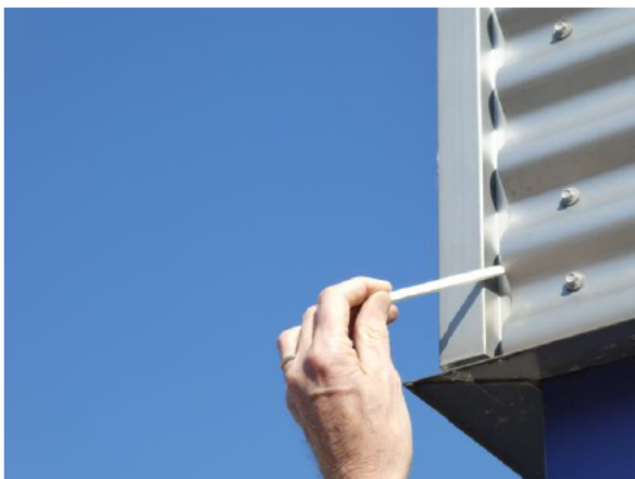
Figuur 21 Ruimte tussen golfplaten
