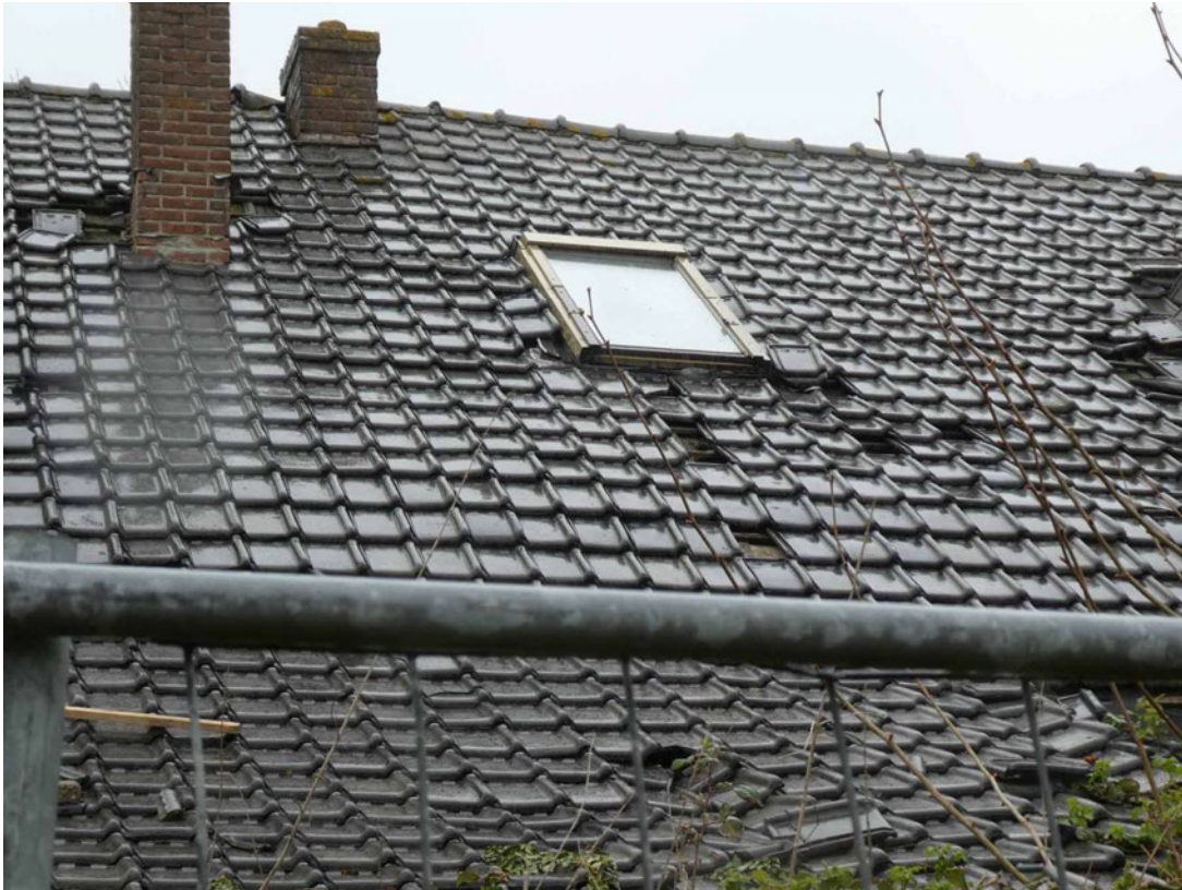
Figuur 14 Dak met veel ontbrekende dakpannen, openingen
