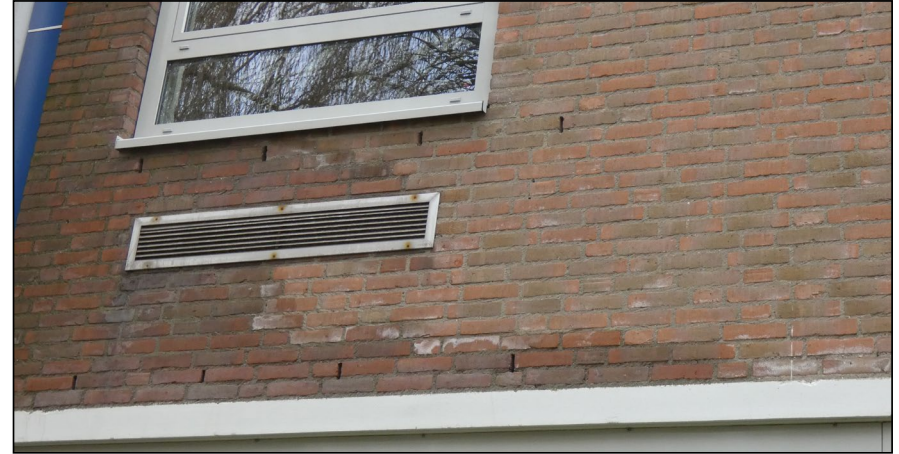
Figuur: op meerdere plekken in de gevels van het Scala Collega zijn open stootvoegen aanwezig. Vleermuizen kunnen verblijfplaatsen hebben in het gebouw.
