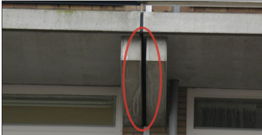
Figuur: bij de balkons van de flat zijn spleten aanwezig, waar vleermuizen in kunnen kruipen en verblijfplaatsen kunnen hebben.
