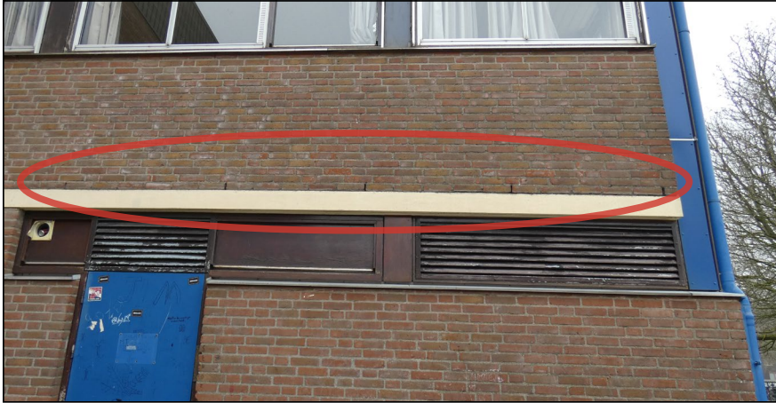
Figuur: de muren bij de ingang van sporthal De Arena hebben open stootvoegen. Hier kunnen vleermuizen inkruipen en verblijfplaatsen hebben in de spouwmuur.
