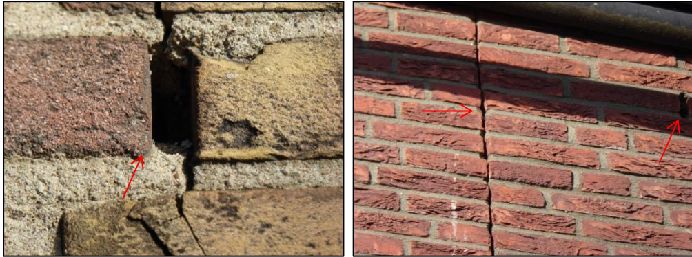
Een impressie van de aangetroffen open stootvoegen, dilatatievoegen en kieren in de bebouwing in het plangebied (weergegeven met rode pijlen).
