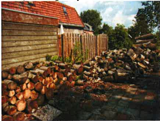
Foto 1, situering stukje asbest
