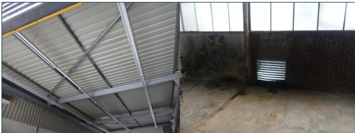
Figuur 3.1 Fotografische weergave van het metalen dak en de gevel, waaruit blijkt dat geen spouw aanwezig is; het ventilatierooster staat direct in verbinding met de buitenlucht.
