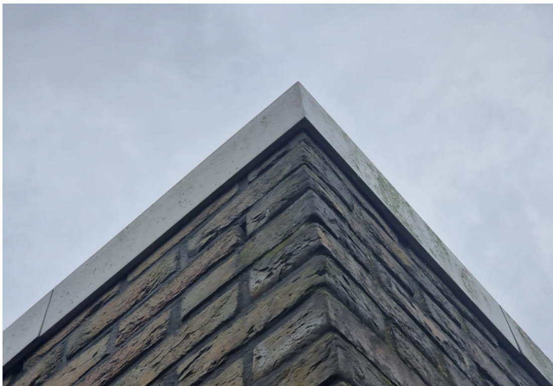
Figuur 3.2 De ruimte onder daklijsten is te krap voor vleermuizen om als verblijfplaats te gebruiken
