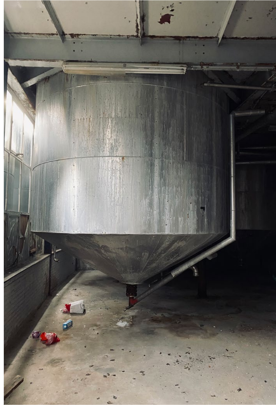
Onderzijde van de ketels op de begane grond van de zeepziederij.
