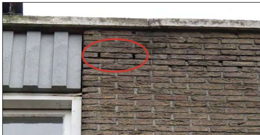
Figuur: open stootvoegen, zoals in de foto omcirkeld, bieden vaak toegang tot een luchtsponw. Hierin kunnen vleermuizen een verblijfplaats hebben.
