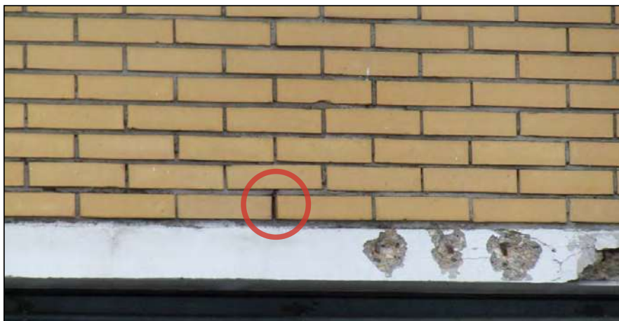
Figuur: op diverse plekken in het plangebied zitten open stootvoegen in de gevels van de panden.
