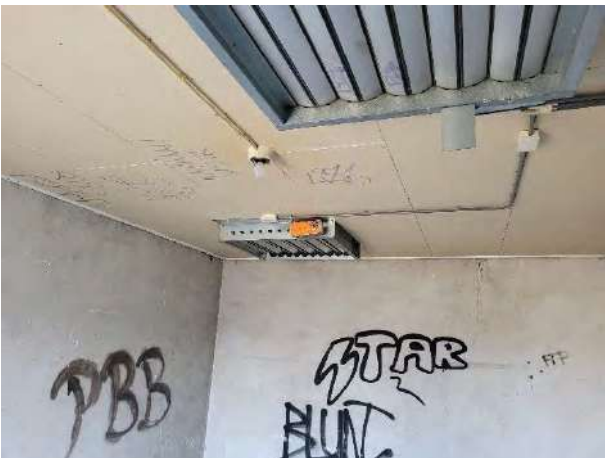
afbeelding 30: afzuiginstallatie in dakopbouw
