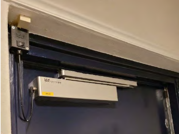
afbeelding 31: toegangsdeur met dranger
