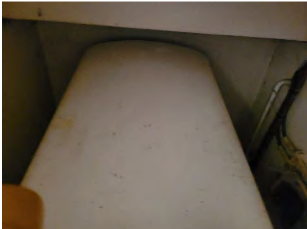
afbeelding 20: elektrische boiler nr. 61
