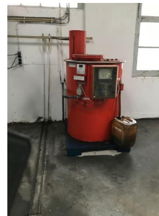
Foto 15 bovengrondse chemische installatie inclusief leidingen.
