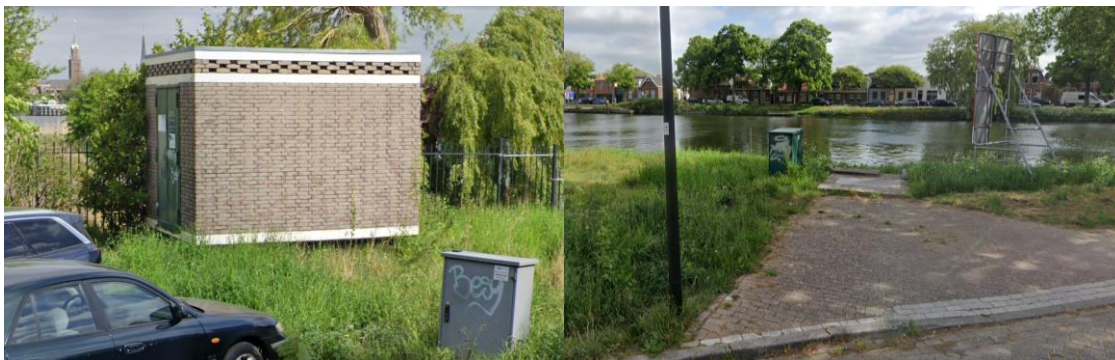
Figuur 6: Aanwezige trafo en elektriciteitskast aan de zuidoost kant van het plangebied.
