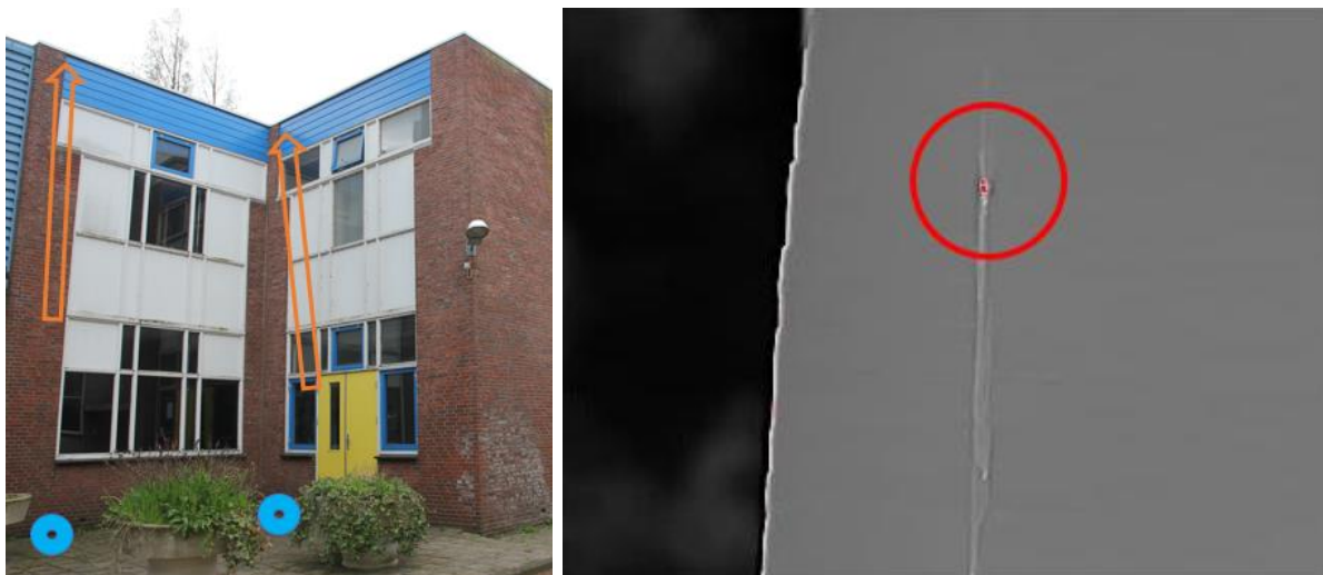
Figuur 4.7. Links: De Hut/Kantine, noord- en oostgevel. Oranje pijlen geven aan waar de paarverblijfplaatsen van een gewone dwergvleermuis zich bevinden. Tijdens het onderzoek zijn onder de openingen van de dakranden ook mestsporen gevonden (blauwe stippen). Rechts: oostgevel van Silo Amerika met de ruige dwergvleermuis (rood vlekje) die vanuit zijn verblijfplaats baltst.
