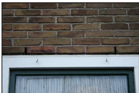
Afbeelding 5: Open stootvoegen in spouwmuur
