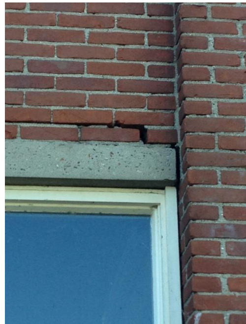
Figuur 8) Gescheurde muur.
