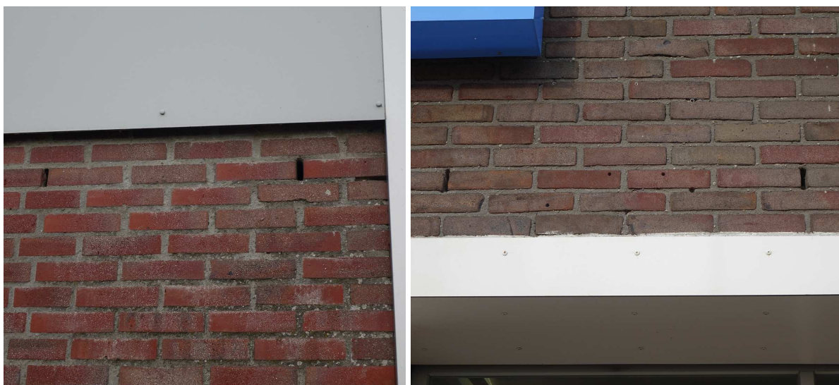
Figuur 3. Verschillende open stootvoegen aan het garagebedrijf.
