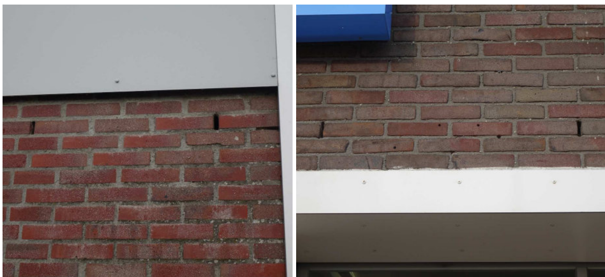
Figuur 3. Verschillende open stootvoegen aan het garagebedrijf.
