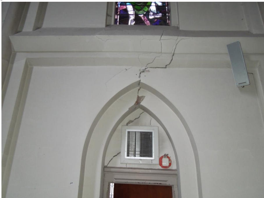
Afbeelding 16 – constructief probleem, zichtbaar vanaf het koor, gezien in oostelijke richting.
