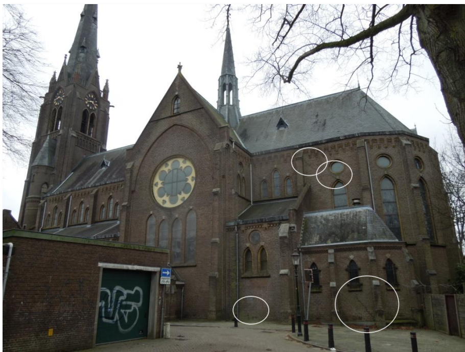
Afbeelding 12 – rechter zijgevel (oostgevel) en koor (noordgevel) met zicht op het oostelijk transept en vieringtoren. De oostelijke langsgevel vertoont op diverse plaatsen (omcirkeld) ernstige scheuren als gevolg van funderingsproblemen. De aard van de scheuren wijzen op een funderingsprobleem van de oostelijke langsgevel.
