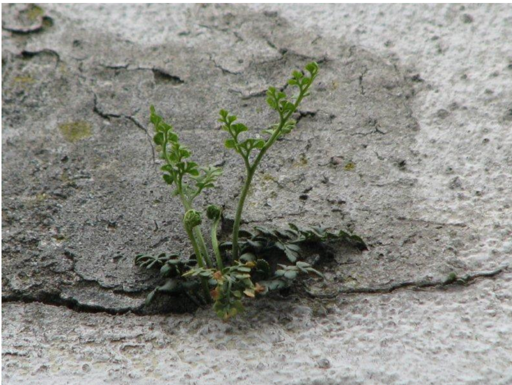
Foto 1 Muurvaren ( Asplenium ruta-muraria L.) aanwezig op de westelijk kopzijde van het middelste gebouw.
