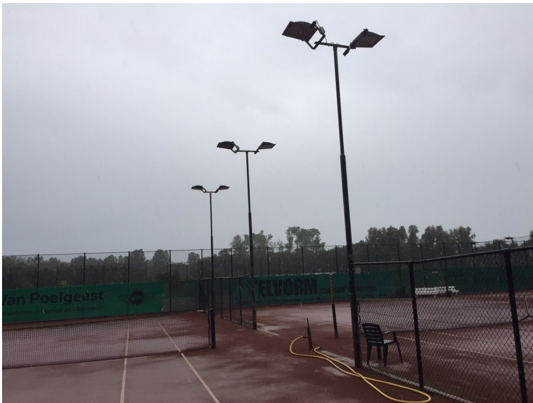
Figuur 1.2 Foto lichtmasten lph 7 meter voorzien van Aerolux 1000 BU
