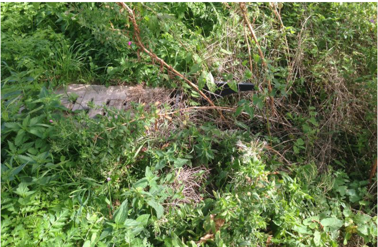
Afb.2: De toegang tot en de ecotunnel zelf onder de busbaan zijn overwoekert
