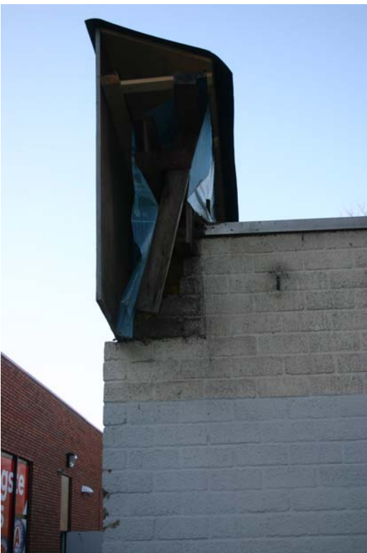
Figuur 4.2.2. De hele zijkant van de betimmering aan de zuidzijde is open.
