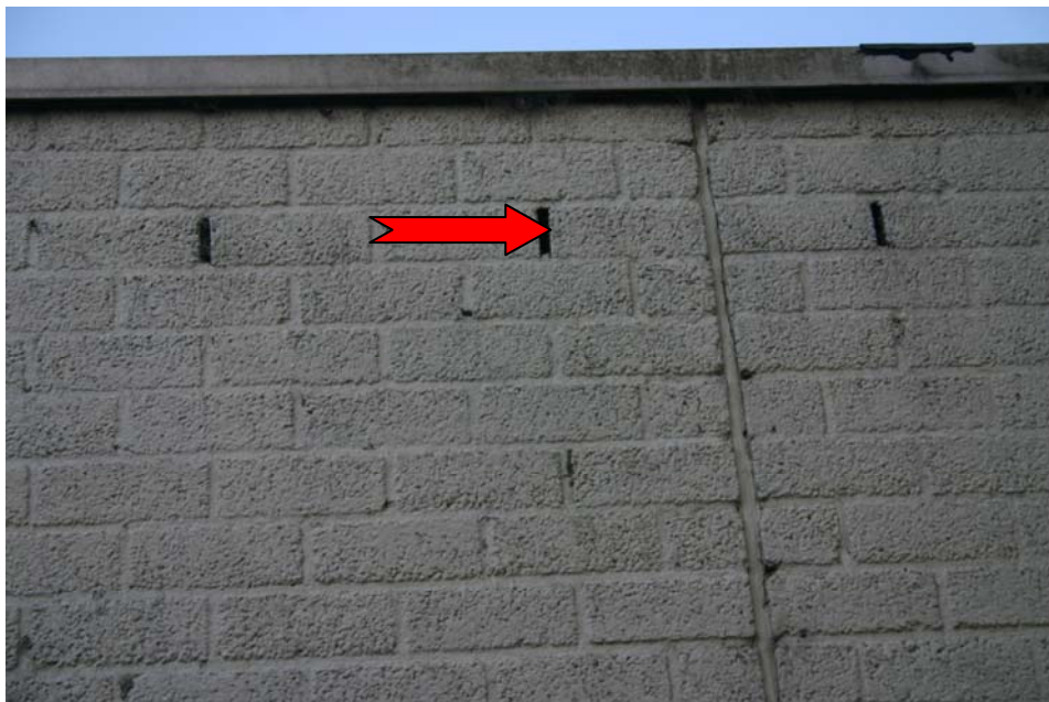
Figuur 4.2.3. Stootvoeg met voldoende breedte en zonder spinnenrag, die vleermuizen toegang kan geven tot de spouw.
