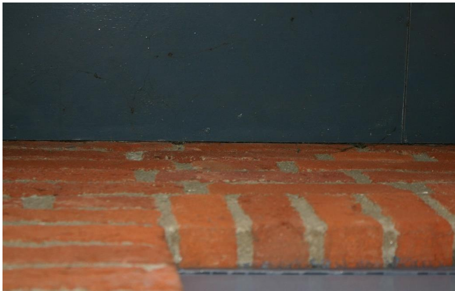
Figuur 4.4.5. Tussen de dakoverstekken en de gevels is geen ruimte voor vleermuizen. De hier zichtbare kier is slechts 2 mm dik.
