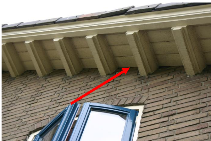
Figuur 4.5.2. Kier in het woonhuis (aangeduid met rode pijl).
