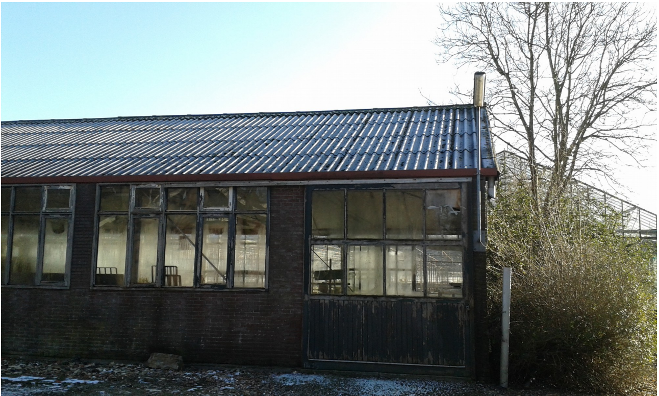
Figuur 4. Het deel van de werkschuur wat ingekort gaat worden. Rechts is wintergroene beplanting te zien en op de achtergrond de kassen. De asbestplaten sluiten niet aan op de nok van het dak, waardoor er openingen te zien zijn. De zijkant van de schuur heeft een houten boeiboord waar de regenpijp in verwerkt is.
