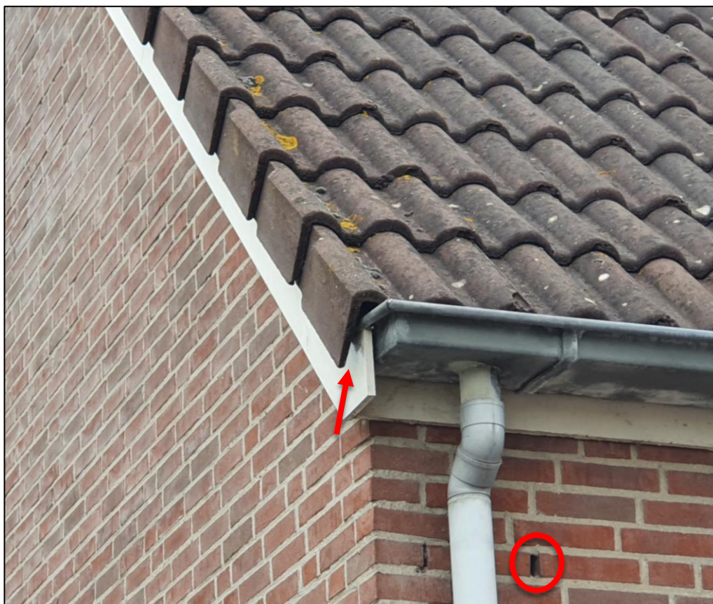
Figuur 4 De zijkant van Kerklaan 22-24 met zichtbaar kierende kantpannen en open stootvoegen.
