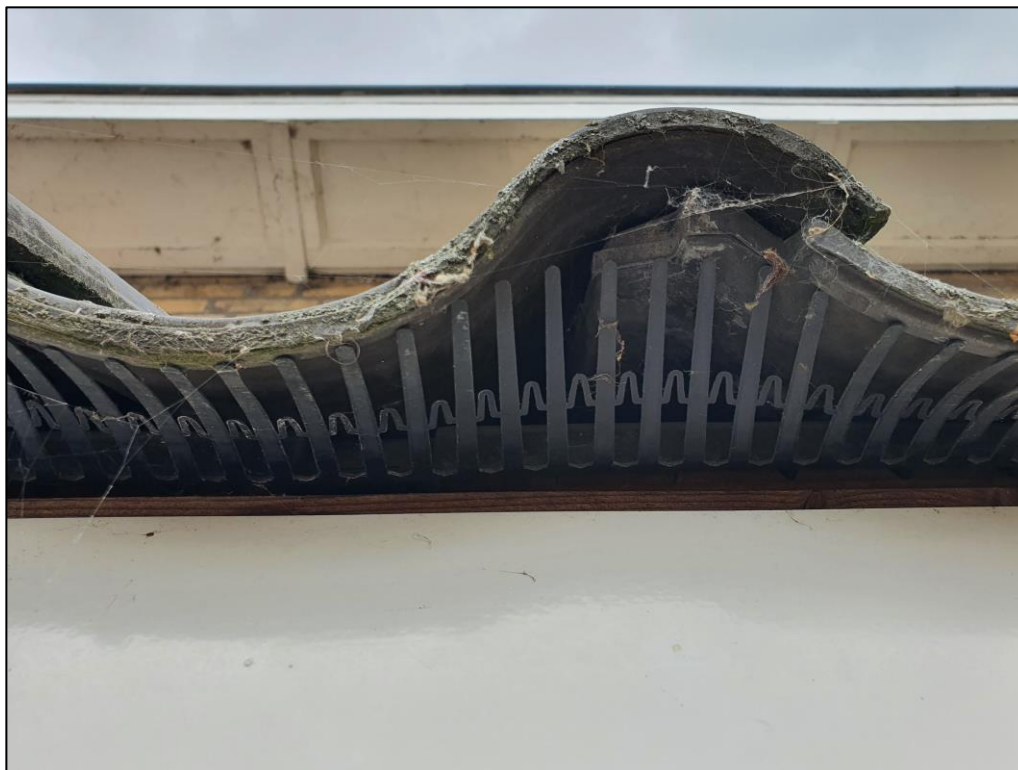
Figuur 5 Het aanwezige vogelschroot onder de dakpannenrand van de daken op de planlocatie.
