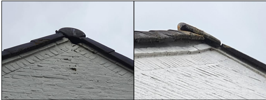
Figuur 6 De kapotte nokvorsten met de zichtbaar kierende kantpannen wat gelegenheid biedt voor gierzwaluwen.
