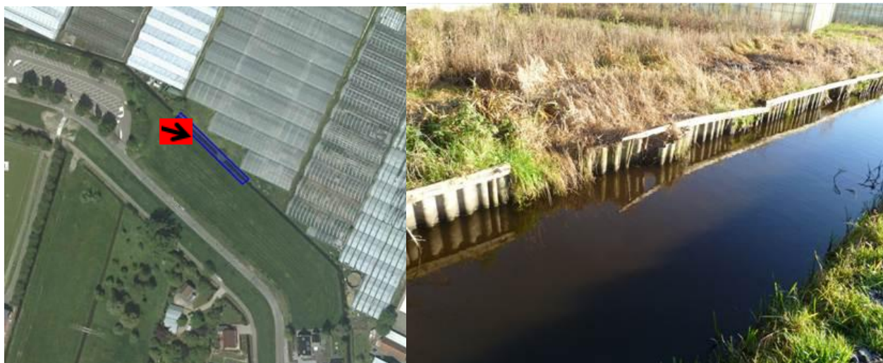
Foto aangetroffen asbestverdachte beschoeiing sloot nabij parkeerterrein Vuurlijn
