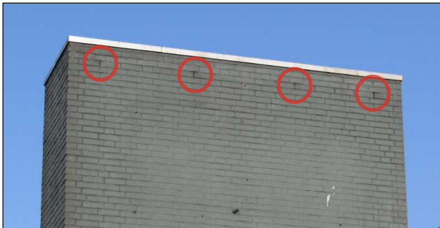
Figuur: open stootvoegen bieden toegang tot de spouwmuur van de supermarkt. De spouwmuur kan door vleermuizen gebruikt worden als verblijfplaats. De open stootvoegen zijn te smal (max. 1,5 cm) voor grotere soorten, zoals laatvlieger en meervleermuis.
