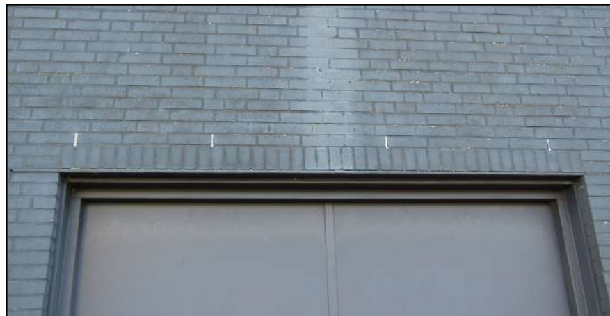
Figuur: boven de dubbele deuren aan de westzijde van het plangebied zijn open stootvoegen opgevuld met metaal, deze open stootvoegen zijn niet toegankelijk voor vleermuizen.
