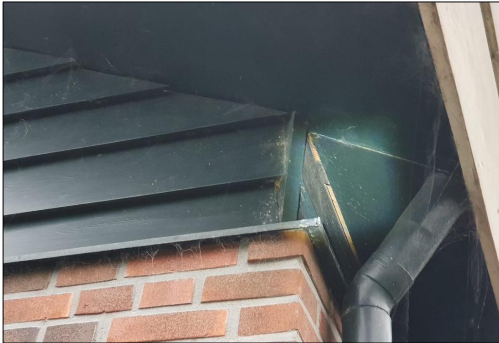
Figuur 4 De zuidelijke zijde van de woning met zichtbaar nauwsluitende gevelbeplating en de aanwezige kier tussen de gevelbeplating en het overstek. Hierbij is het dakbeschoth zichtbaar. De opening leidt derhalve niet naar de kruipruimte tussen het dakbeschoth en de dakpannen.
