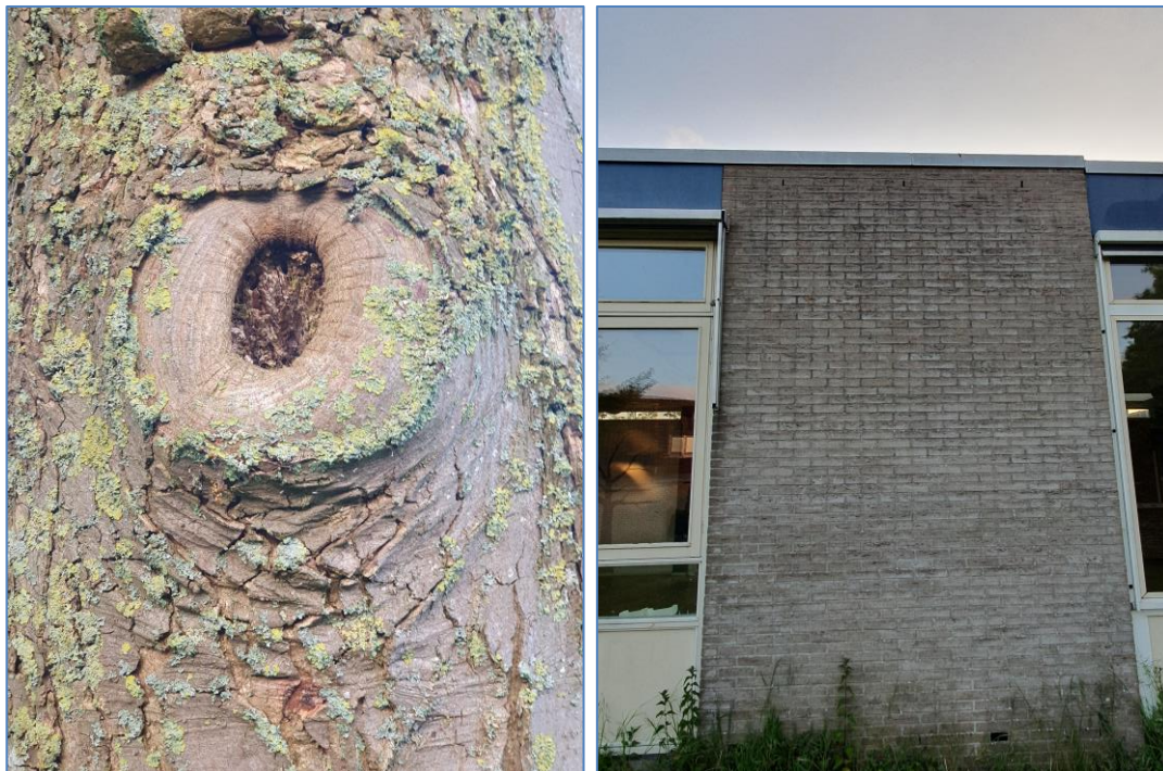
Figuur 8: Links dichtgegroeid litteken; rechts open stootvoegen bovenin de muur
