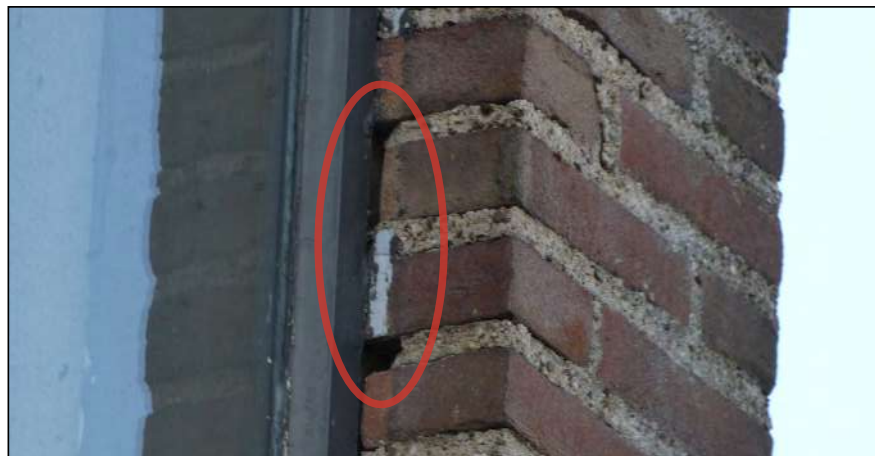
Figuur: er zijn openingen in de muur bij de kozijnen van de sporthal. Vleermuizen kunnen hier verblijfplaatsen hebben.
