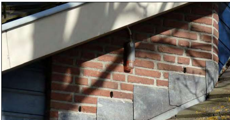
Figuur: de apotheek heeft open stootvoegen waardoor vleermuizen de spouw kunnen bereiken en daar verblijfplaatsen kunnen hebben.
