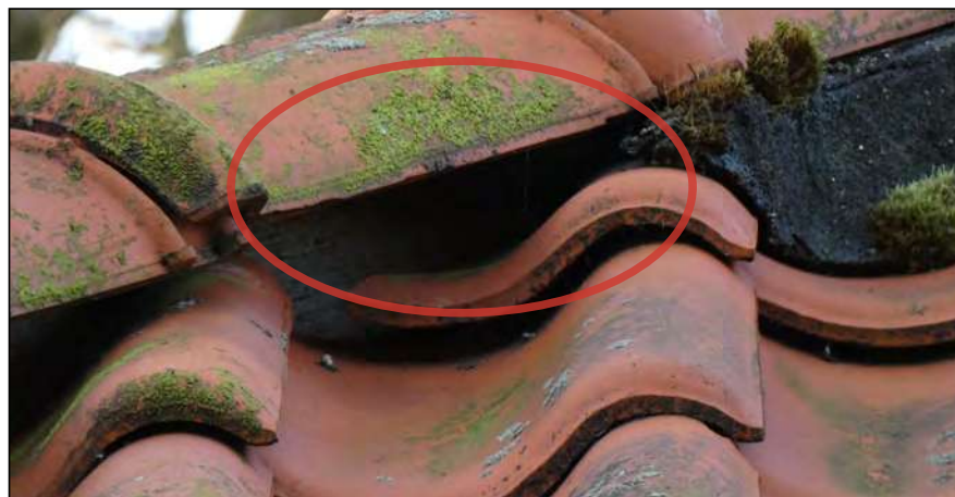
Figuur: op het dak van het gebouw van de ijsclub is ruimte onder enkele dakpannen. Hier kan huismus broeden of kunnen vleermuizen verblijfplaatsen hebben.
