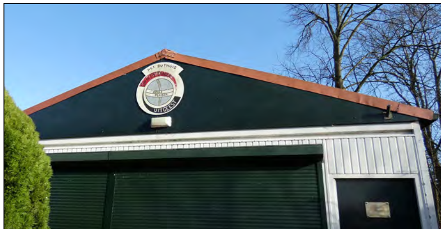
Figuur: het gebouw van de jeu-de-boules vereniging is ongeschikt voor huismus, gierzwaluw en vleermuizen. Het gebouw bestaat geheel uit metalen platen en er zijn geen geschikte openingen aanwezig.
