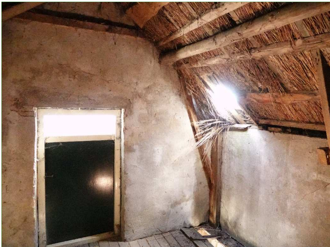
Gat in de dakbedekking aan de noordwestzijde van de schuur.
