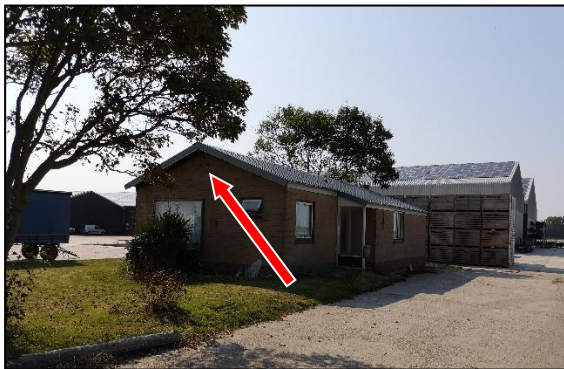
Afb 7: Enkele bomen en struiken. In topgevel enkele dichtgemaakte ventilatieopeningen (rode pijl)
