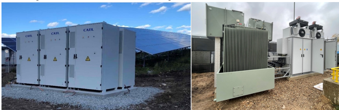
Figuur 2.1 Impressie van een batterijcluster (linker afbeelding) en de transformator (rechter afbeelding, links) en inverter (rechteraafbeelding, rechts)
