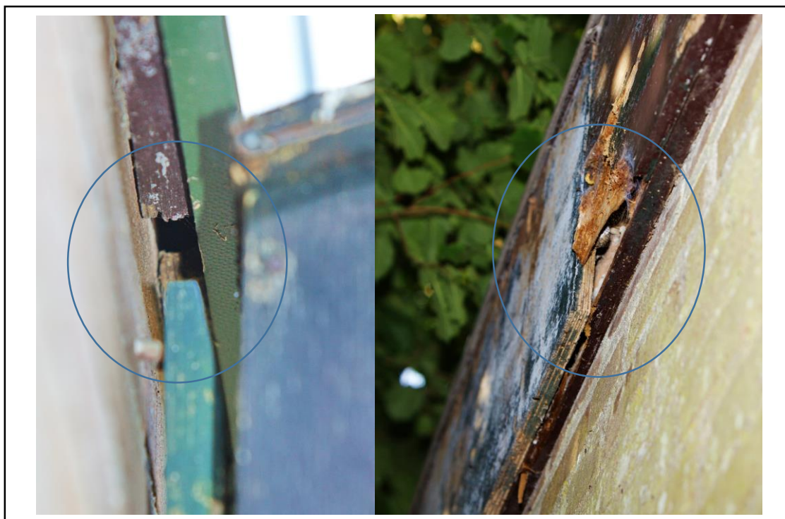
Figuur 7: Enkele voorbeelden van gaten in de dak beschoeiing (links hoofdpand en rechts bijgebouw)
