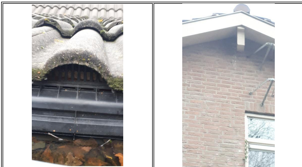
Afbeelding 8: Vogelschoot in de dakgoot (links) en krijtstrepen die zijn aangetroffen bij de nok (rechts) (Aveco de Bondt, 2019).
