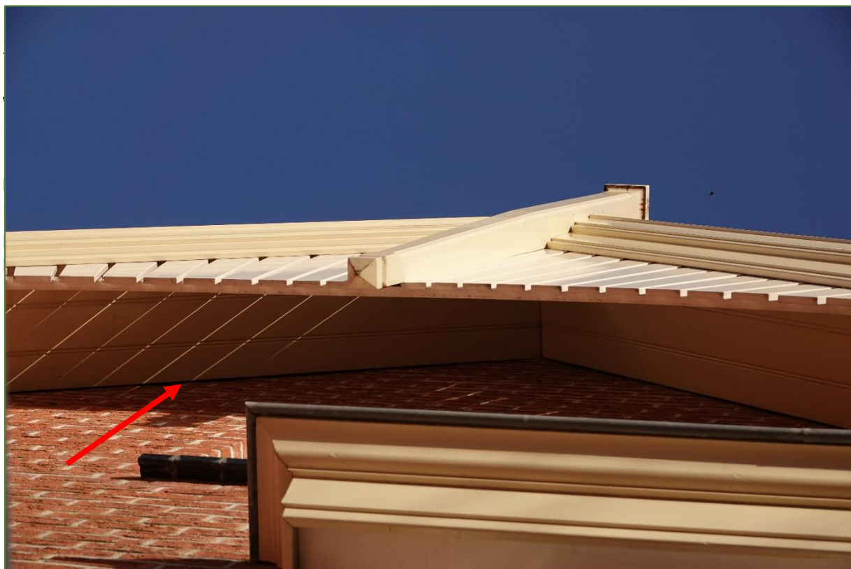
Figuur 9 Een spleet tussen houten betimmering en een gemetselde muur aan de zuidzijde van de bebouwing.
