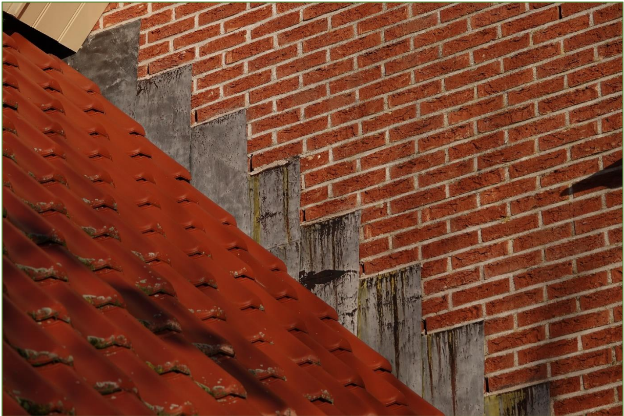
Figuur 10 Een rij open stootvoegen op een van de gemetselde muren.
