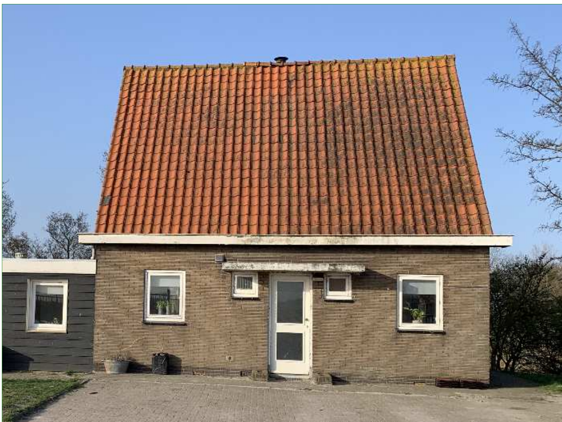
De woning aan Provincialeweg 1 met tot ver in de dakgoot lopende dakpannen.
