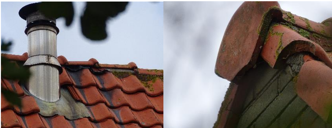
Afbeelding 7.6 Losse dakpannen en een nokpan met een opening waaronder vleermuizen kunnen verblijven
