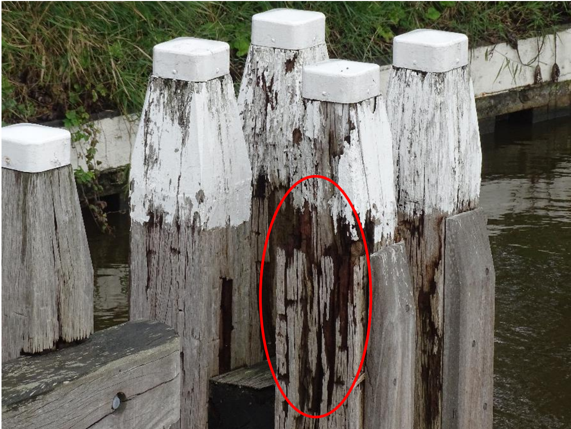
Afbeelding 7.5 Scheuren in aanmeerpalen welke mogelijk als verblijfplaats gebruikt kunnen worden door vleermuizen
