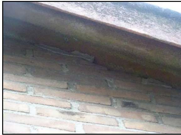
Afbeelding 5: Ruimte tussen de muur en de dakplaten bij de dakrand
