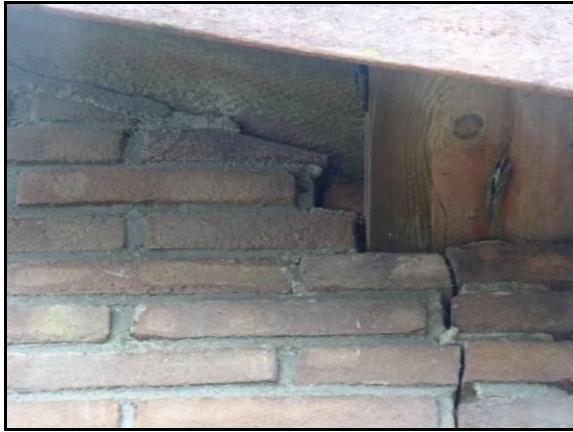
Afbeelding 4: Ruimte tussen muur en één van de balken onder de dakrand
