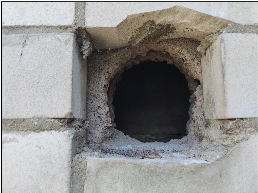
Figuur 4 De schoorsteen tussen de woning en de schuren beschikt over 2 grote openingen aan de zijkanten en is open aan de bovenzijde. Hierdoor ontstaat een tochtstroom.
