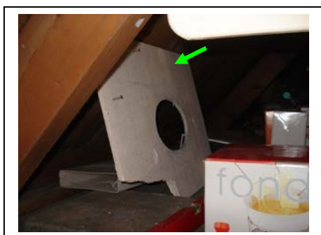
Foto 13 Asbest niet aantoonbaar
