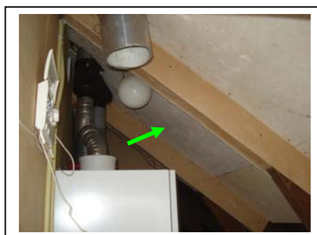
Foto 14 Asbest niet aantoonbaar
