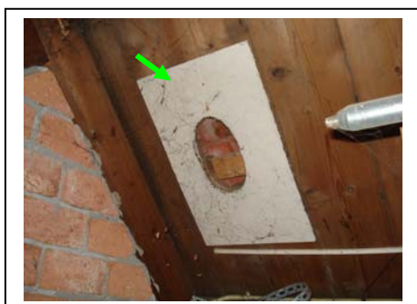
Foto 11 Asbest niet aantoonbaar
