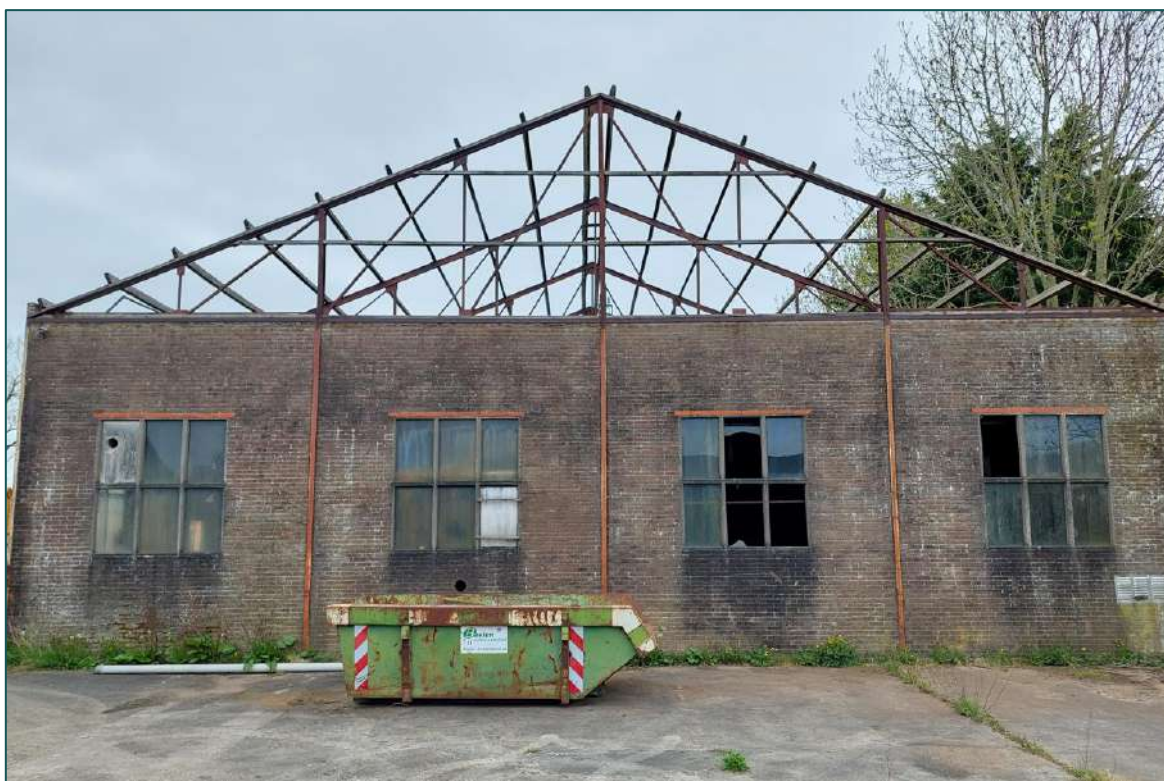
Figuur 2 Loods B beschikt evenals loods D niet over een dakbedekking.
