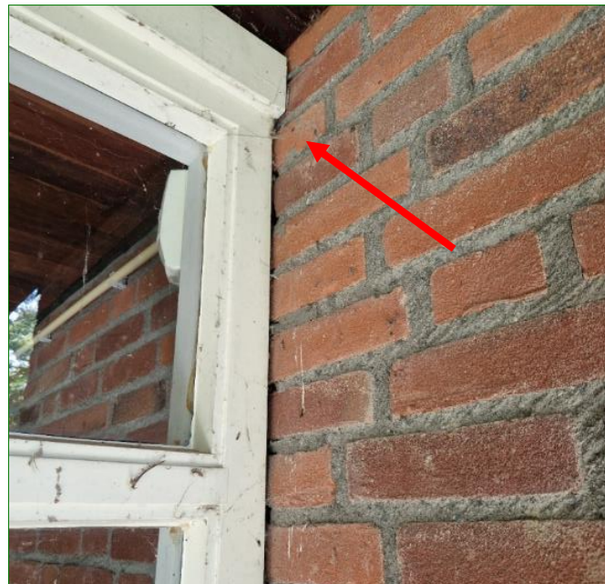
Nestplaats (rode pijl) van Boomkruiper naast kozijn in de oostgevel.
