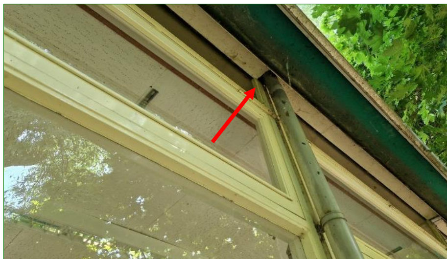
De openingen naast een regenpijp (rode pijl) aan de zuidzijde van de bebouwing geven mogelijk toegang tot voor vleermuizen geschikte achterliggende ruimtes
